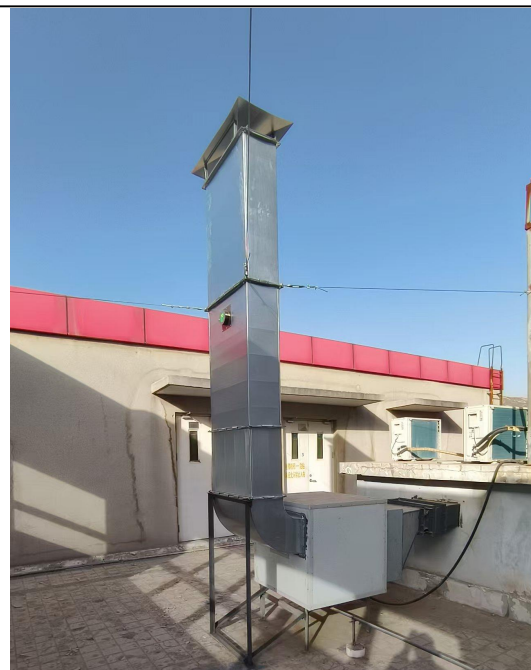
活性炭吸附+排气筒
